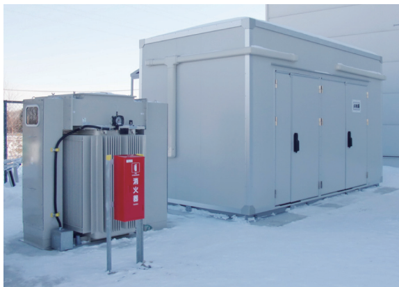
図4 左：連系変圧器 右：屋外用パッケージ（交直変換器盤収納）
