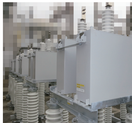
図5 大電力試験所に設置した生分解性絶縁油適用コンデンサ
