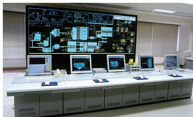
図2.8 AQUAMATEシリーズ 200312-③ (神戸市建設局 中央水環境センター 中央監視制御室)
