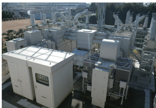
図3.5.1 当社前橋製作所66kV特高受変電設備
