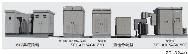
図 3.2.1 PCS250kW器×2台と500kW器×1台の設置状況
