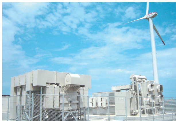
図 2.4 株式会社ユーラスエナジー宗谷殿 宗谷岬ウインドファーム納めSVC
