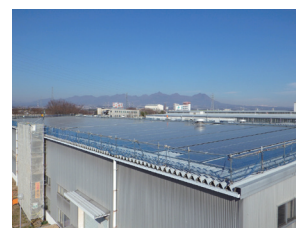
図 3.2.6(b) 工場屋根設置全景
