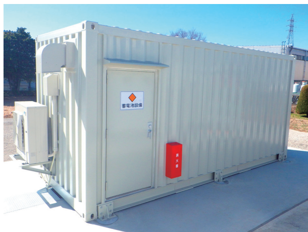
図 3.3.5 電池収納コンテナ外観
