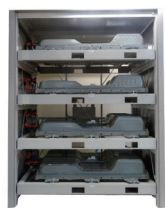
電池オープンラック (96kWh)
