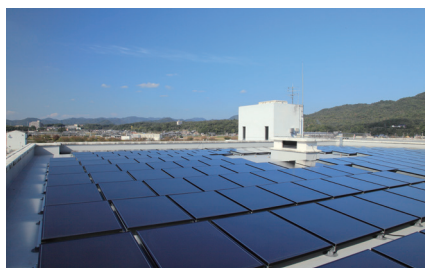
図2 管理棟上部太陽電池設置状況
