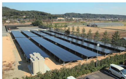
図1 地上部太陽電池設置状況
