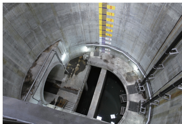
図6 雨水貯留管（乙訓ポンプ場）
