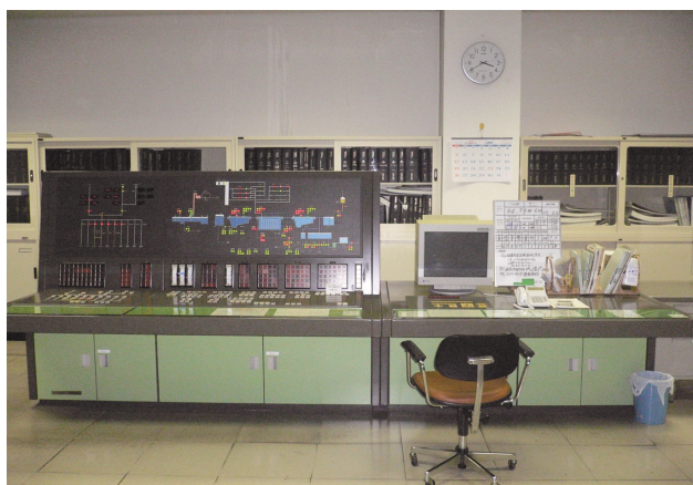
図8 更新前の監視制御システム
