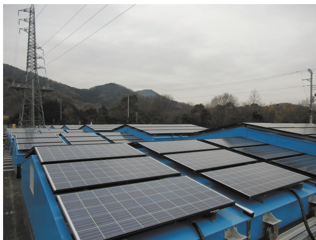
図1 太陽光パネル
