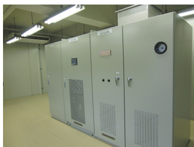
図2 集電箱(奥)・パワーコンディショナ(中央)・系統連係盤(手前)
